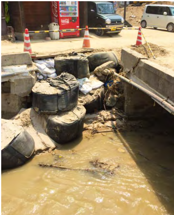
現地の被害の様子
